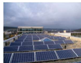
PV-Anlage auf Geschäftsgebäude der Stadtwerke Energie Jena-Pößneck
